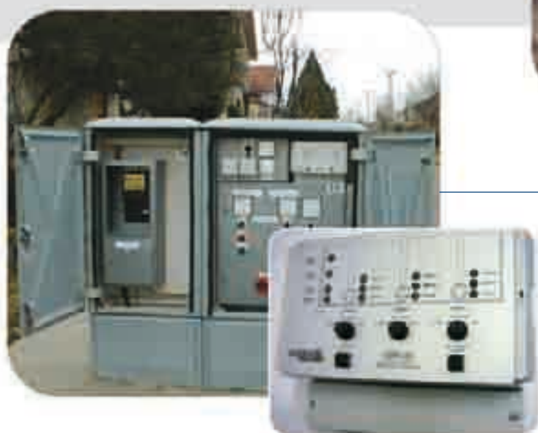
Автоматизация и дистанционное управление, и надзор канализационной насосной станции (фирма INDAS разработала собственный автомат для управления канализационными насосными станциями)
